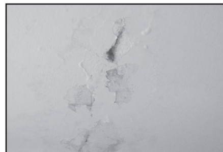
Pomalowane w grudniu pomieszczenia poradni pediatricznej (na zdjęciu) oraz sufit korytarza zostały zalane przez lokatorów I piętra.
